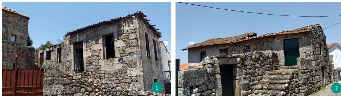
Figura 40 - Edifícios em péssimo estado de conservação na ARU de Tabosa do Carregal 1 – Rua do Convento; 2 – Rua da Carga
