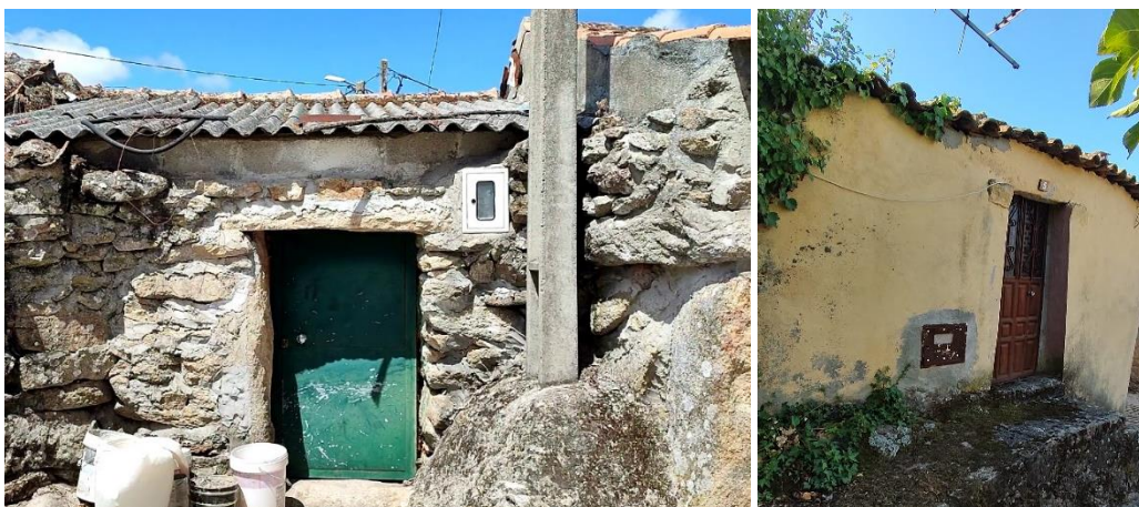
Figura 40 – Edifícios em mau estado de conservação.
