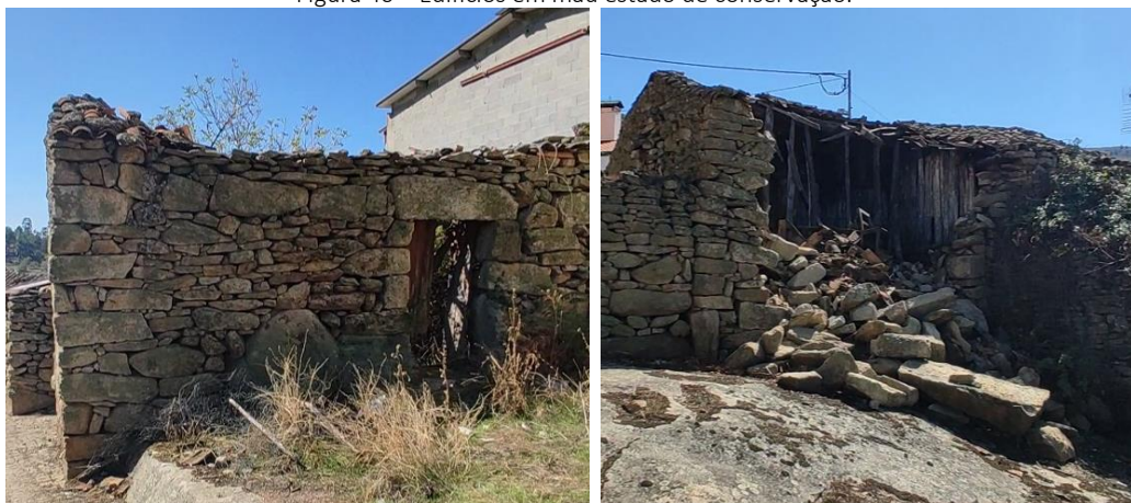
Figura 41 – Edifícios em péssimo estado de conservação.
